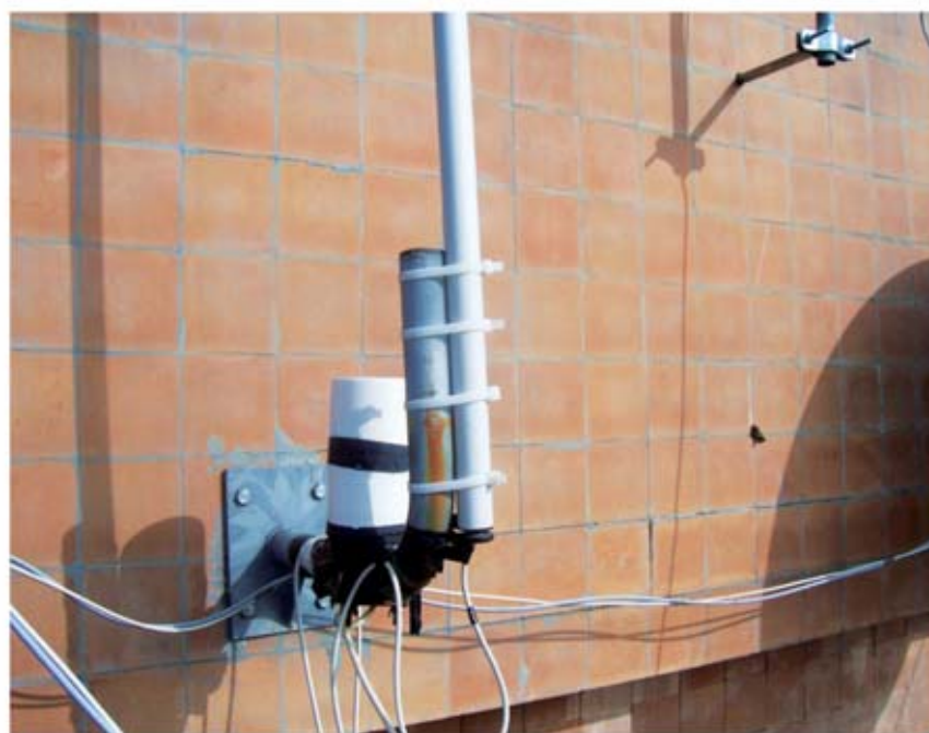
Fig. 6 Así hemos resuelto el problema de la fijación del tubo que contiene el amplificador.
