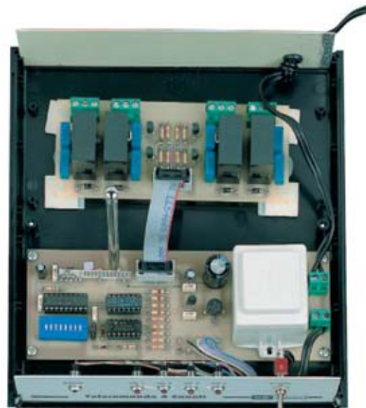
Fig.6 En este caso dentro del mueble se ha instalado la tarjeta del Receptor LX.1410 con la tarjeta de 4 relés mostrada en la Fig.4.
